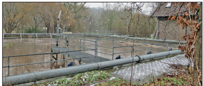
Die sanierungsbedürftige Kläranlage in Aub, Text u. Bild: Alfred Gehring
