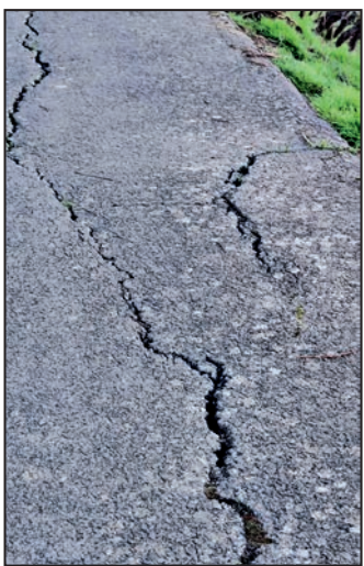
Die Risse im Weinbergsweg sind teils 20 Zentimeter tief. Foto: A. Roscoe
